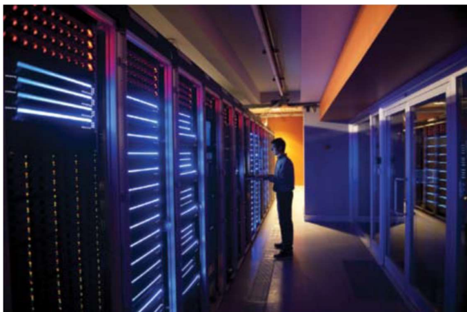
រូបភាពទី ៣.៩៖ មជ្ឈមណ្ឌលទិន្នន័យ cloud computing data center
